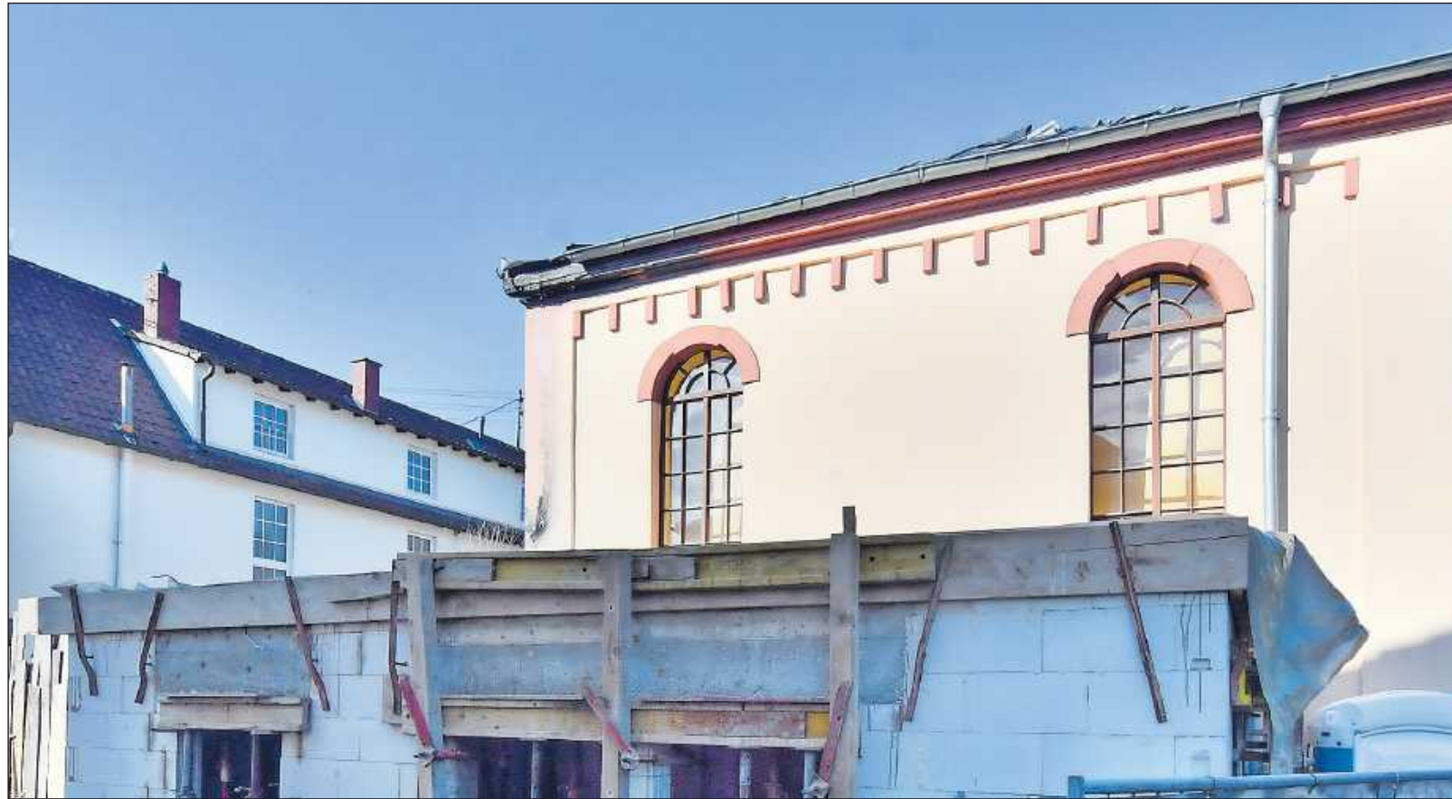
Innerhalb von drei Monaten soll der Brandschaden an der ehemaligen Synagoge behoben sein. Die Arbeiten starten im Januar 2018.
